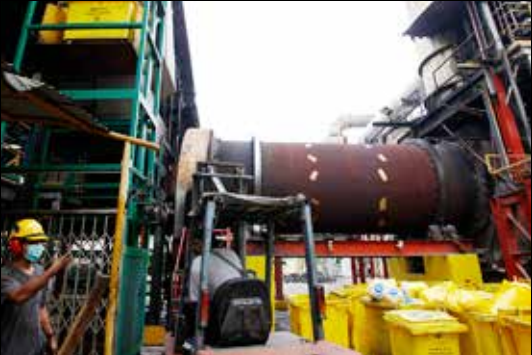
Incinerador para procesar desechos médicos. La incineración de los desechos médicos se lleva a cabo poco después de su llegada a la instalación, y lo que no se puede incinerar rápidamente se almacena en un almacén frigorífico.
